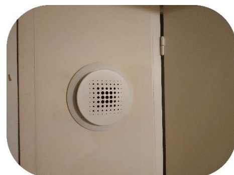
Bouche de soufflage du sous-sol
